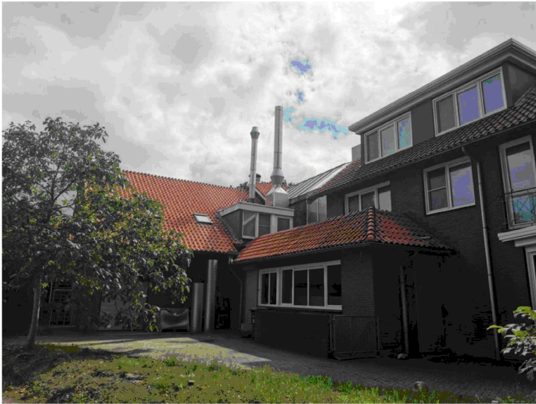
Afbeelding 2.3 Foto's nieuwe afzuiginstallatie
