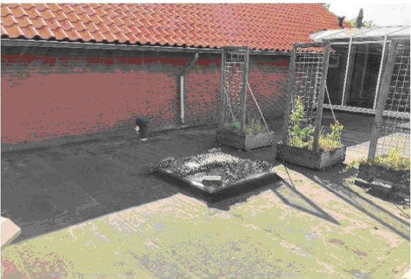
Afzuiging toilet eetzaal
