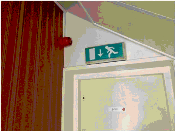
Noodverlichting in de relax ruimte boven de sauna is defect.
