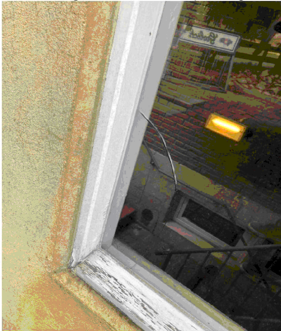
Het raam aan de kopse kant van het gebouw nabij de speeltuin is gebarsten.
