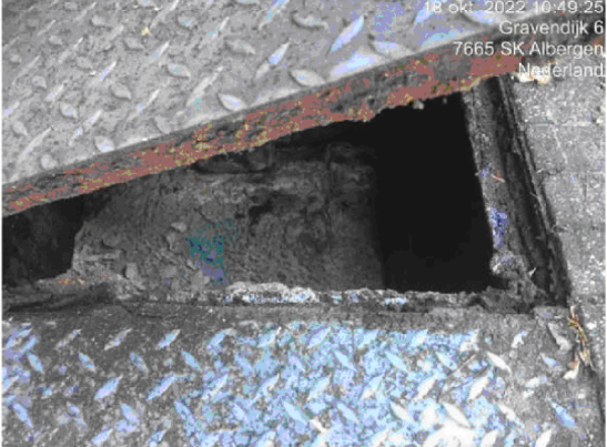
Inkijk in geopende zuiveringstechnische voorziening
