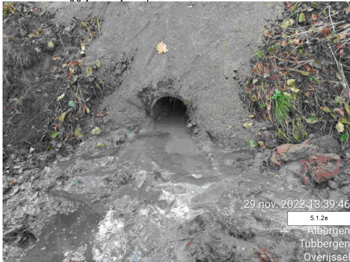
Foto 4: Uitstroming grijze klei bij doorspuiten duiker
